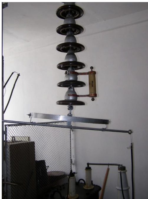
Рисунок 1.1 – Общий вид гирлянды из подвесных изоляторов со стандартным шаровым разрядником и экраном для выравнивания распределения напряжения вдоль гирлянды
