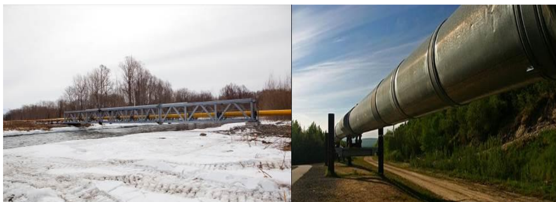
Рисунок 1.17 - Надземная прокладка трубопроводов
